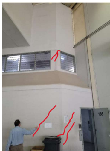
Figura 3. Fisuras en entrada a uno de los sectores
