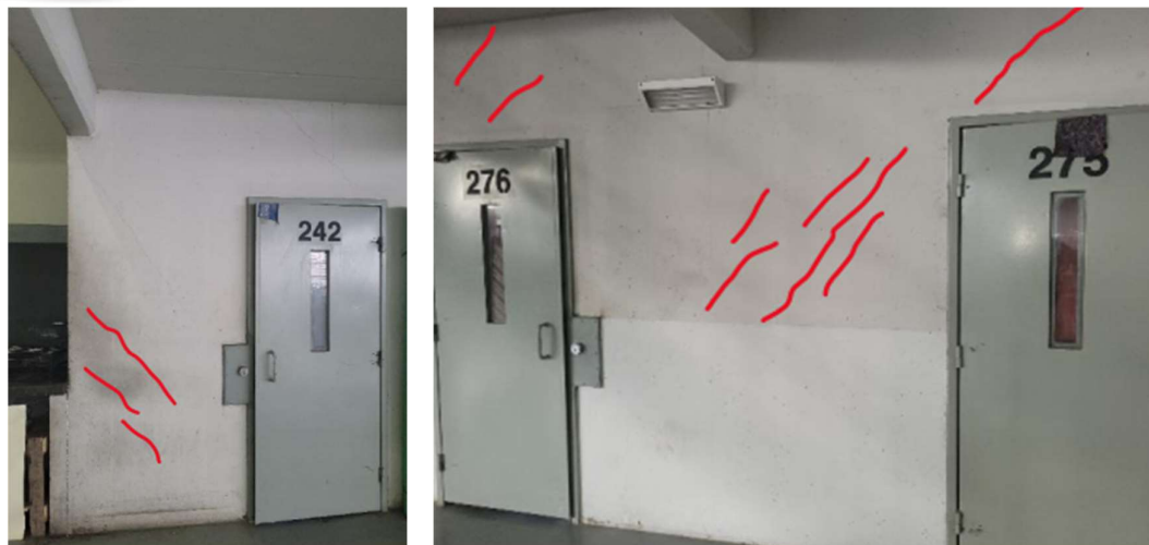
Figura 4 (a). Fisuras en tabiques interiores
