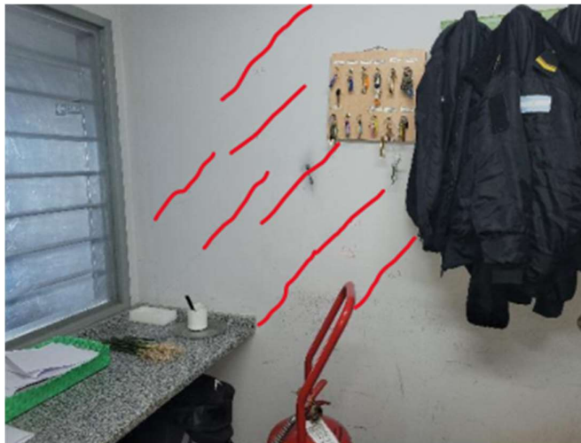
Figura 5 (a). Fisuras en núcleo central N (planta baja)
