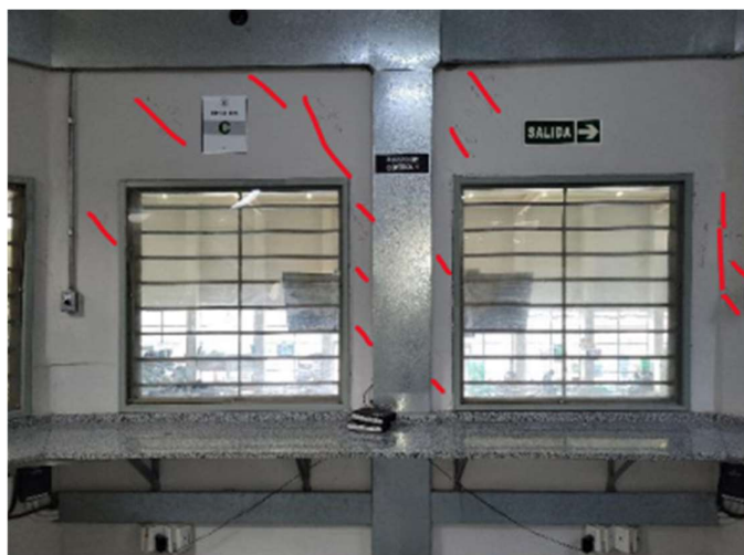
Figura 5 (b). Fisuras en núcleo central N (planta alta)
