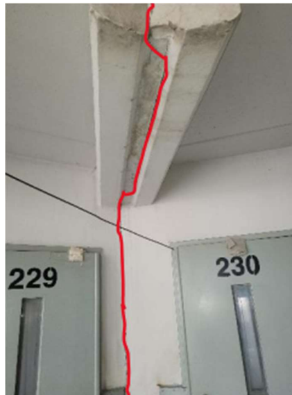
Figura 6. Separación en una junta constructiva
