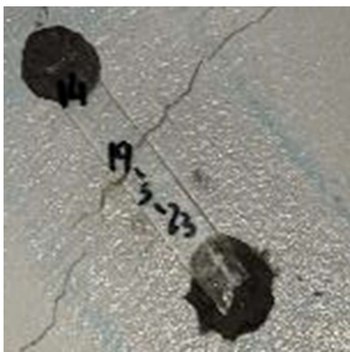
Figura 7. Control de fisuras con testigo de vidrio
