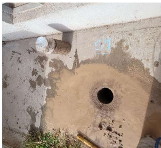
Figura 10 (a). Evaluación de socavones
