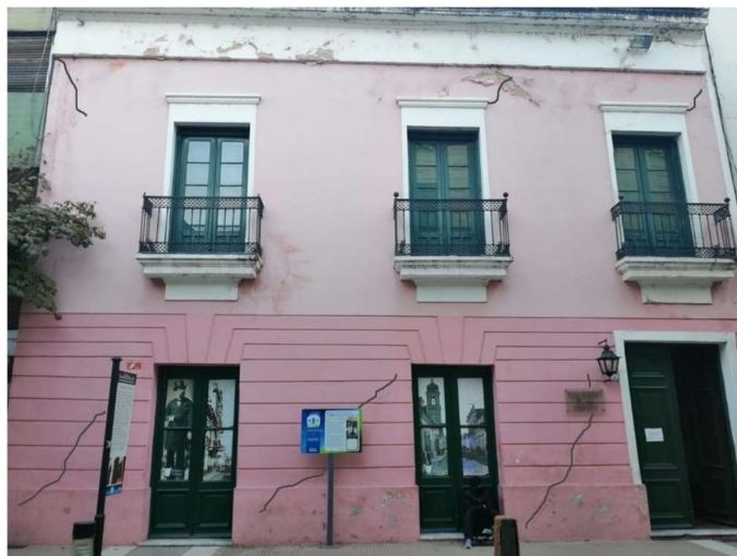
Figura 1. Muro de mampostería de la fachada del Museo Nicolás Avellaneda, San Miguel de Tucumán. En color negro se resaltan las fisuras más relevantes (Loretto, Gutiérrez & Luege, 2022) [2]
