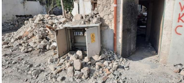
Figura 14 – Daños en instalaciones de gas
