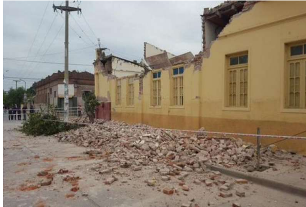
Foto 11 – Edificio escolar colapsado El Galpón, Salta
