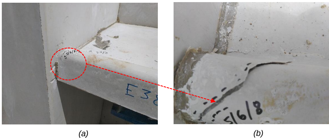
Figura 16. Rotura generada en la pieza durante el ensayo. (a): vista general; (b): acercamiento
