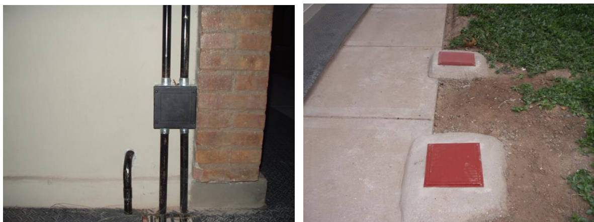
Figura 6: Instalaciones complementarias para el tendido e inspección de los cables de los sensores
