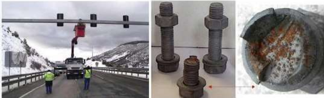
Figura 13 - Inspección en servicio y bulones retirados de la junta del tramo medio. Fuente: Iordachescu et al. (2022)
