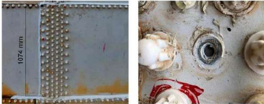
Figura 14 - Detalle de la unión del tanque de agua y bulón roto. Fuente: Boschetti Pereira et al. (2022)
