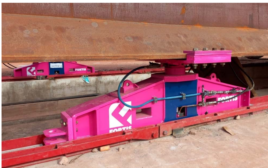
Figura 6. Skidshoes y carriles metálicos sobre pista de deslizamiento (Fuente: FORTIS)
