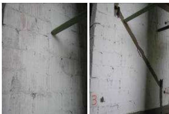
Figura 12 – Exemplos de fissuras iniciais
