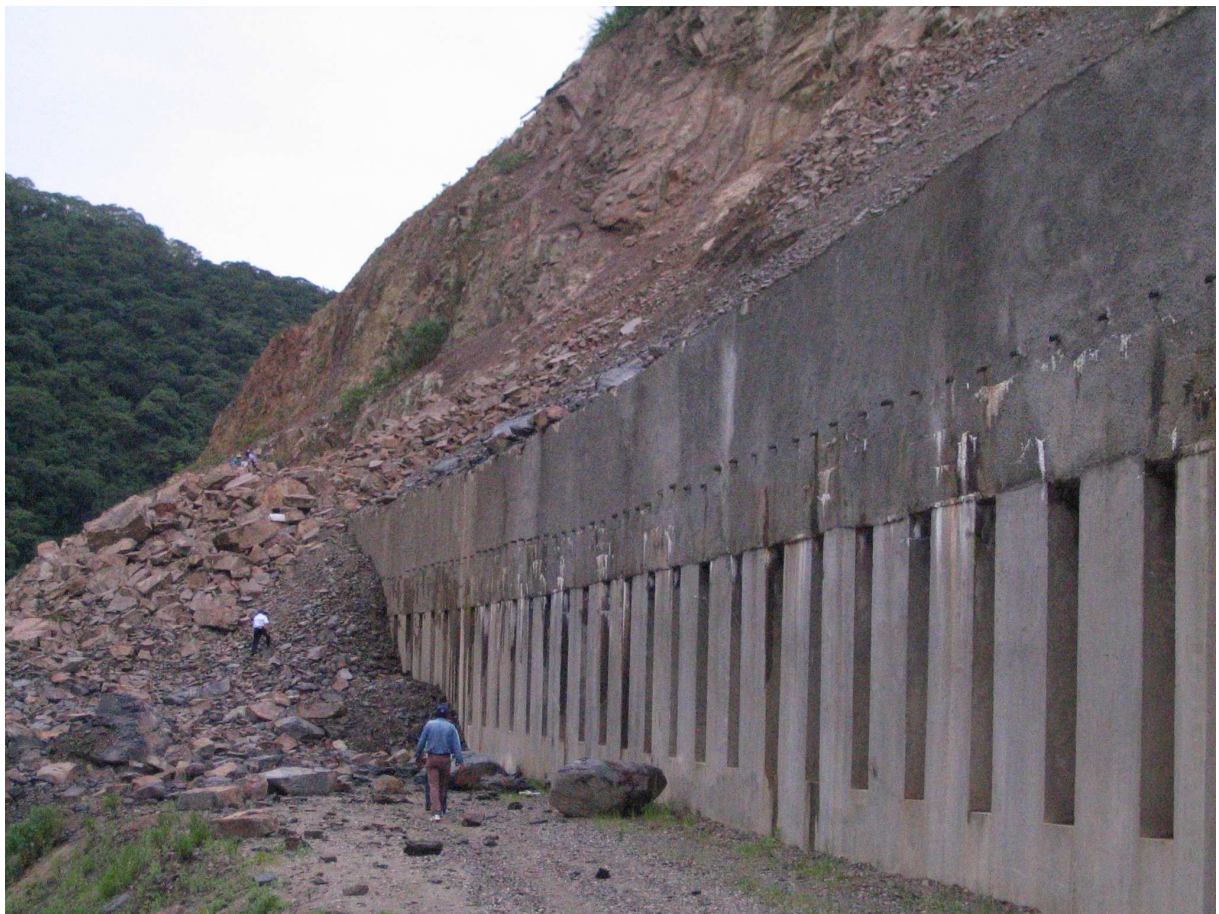
Fotografía No. 2: Antes del colapso (enero, 2007)
