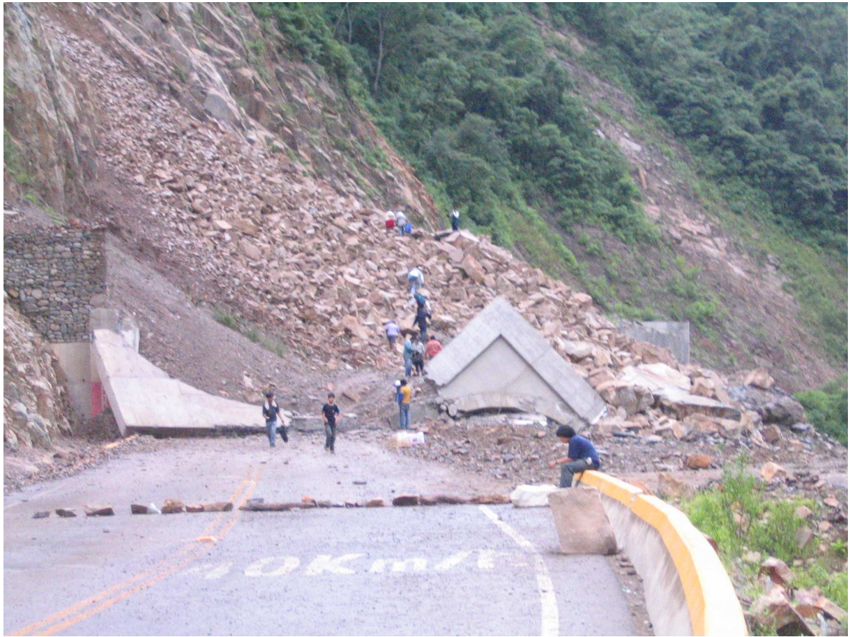
Fotografía No. 3: Después del colapso (enero, 2007)
