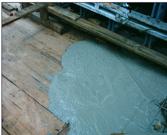
Fig. 14. Falta de estanqueidad
