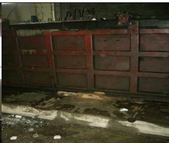
Fig. 17. Falta de estanqueidad
