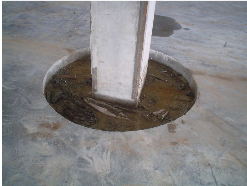
Fig 9. Junta de aislamiento en columnas
