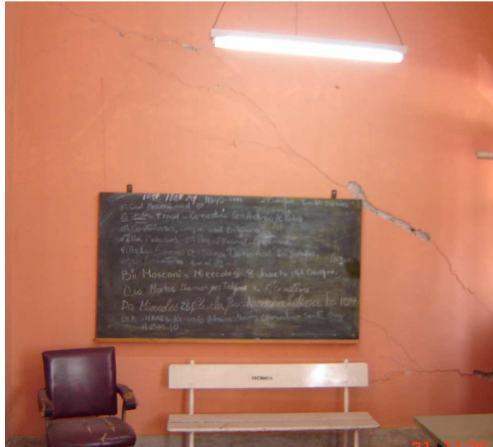
Figura 13 Fisuras en muro interior
