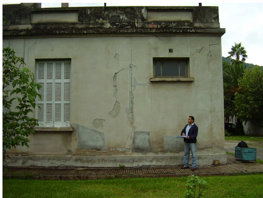
Figura 11 Fisuras en parte de la fachada oeste
