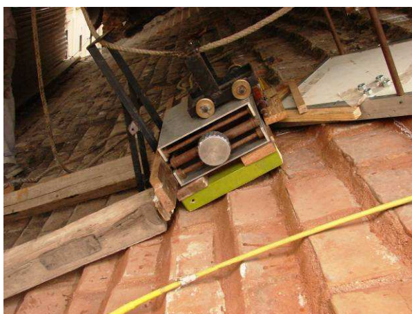
Fig. 22 – Equipo emisor ubicado sobre la cubierta
