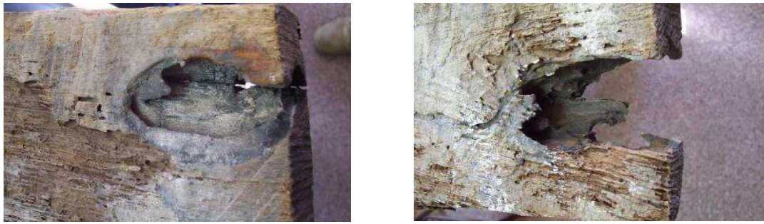
Fig. 16 – Daños provocados por termitas en tablón ensayado
