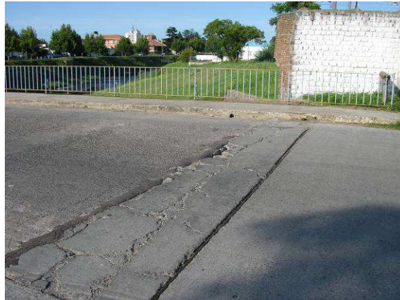
Figura 6 - Deterioro de la calzada, juntas de dilatación insuficiente y sin mantenimiento.
