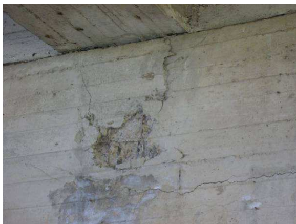
Figura 7 - Vista del estribo del puente nor- oeste. Fisuras y descascamientos
