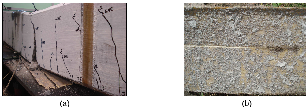
Figura 7- (a) viga VRA.F_1 após o colapso; (b) detalhe da fina camada de concreto aderida ao PRFA.
